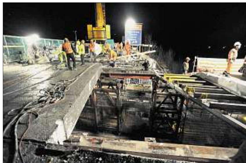
Waren die alten Elemente weg, konnte man auf die SBB-Fahrleitungen sehen.
