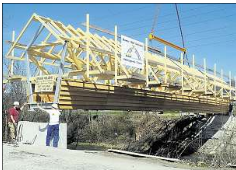
Der neue Steg ist an seinem Platz. Nun müssen noch Anschlussarbeiten erledigt und das Dach eingedeckt werden. (Kurt Kassel)
